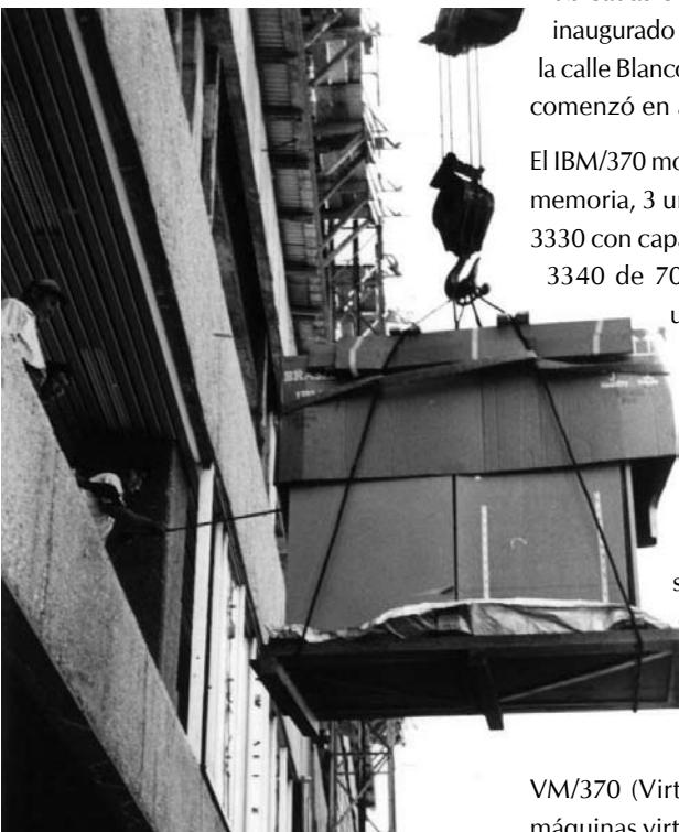
Instalación del IBM/370 en el segundo piso del nuevo edificio de Blanco Encalada (1975)
