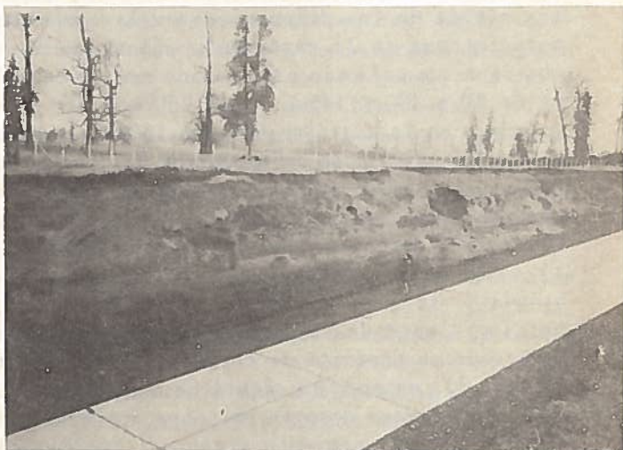
Foto 7. Corte del camino al sur del puente sobre el Estero Sagllue
