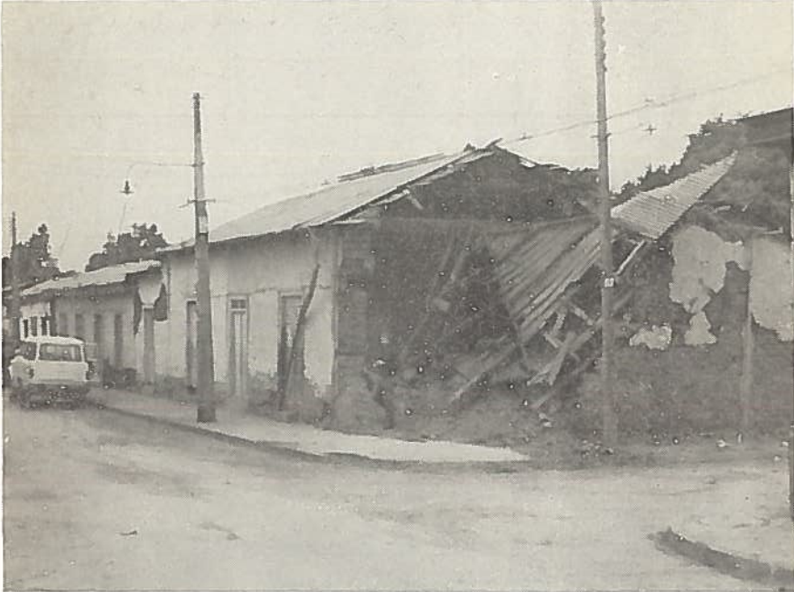
Foto 18. Daños en La Ligua. Calle Ortiz de Rozas, acera Norte. Típico daño en las esquinas. Edificación de adobe grueso, con vigas de madera y techado de fierro galvanizado.
