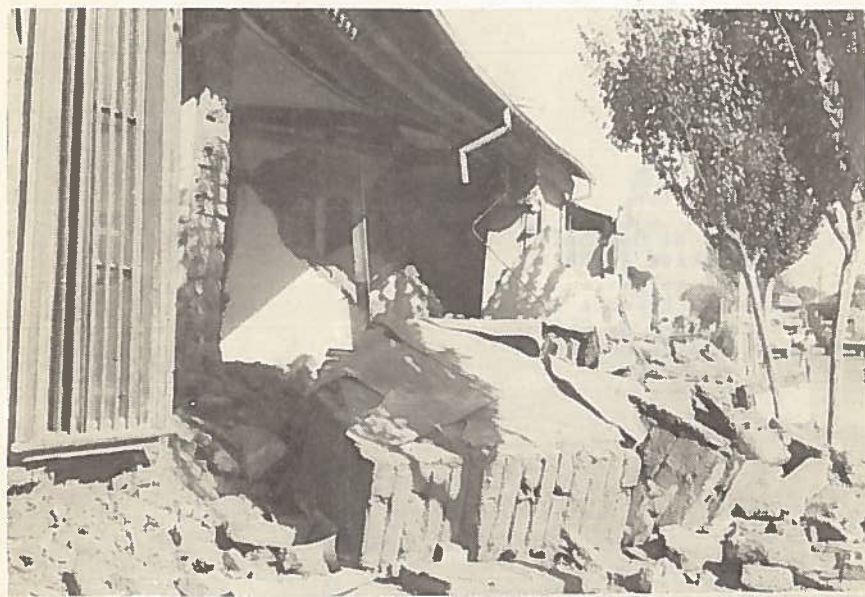
Foto 22. Daños en Nogales, acera E de la calle principal
