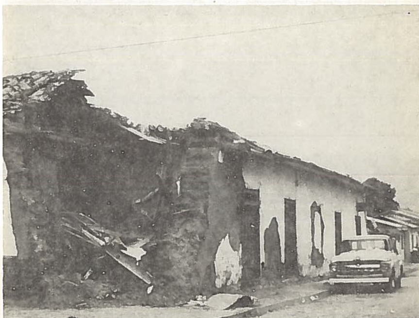
Foto 17. Daños en La Ligua. Edificación Tipo C.
