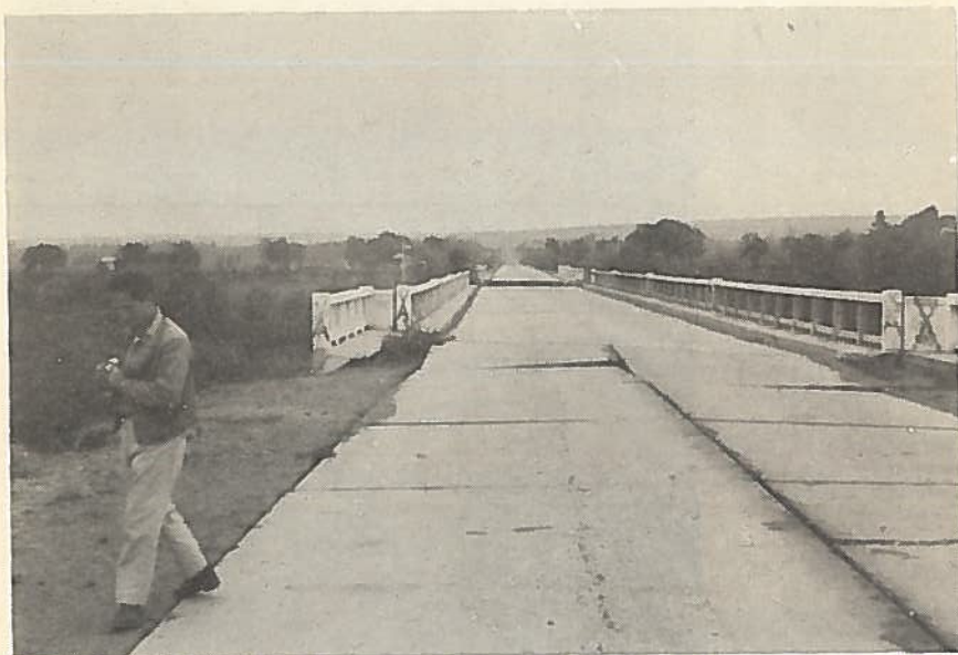
Foto 5. Desplazamiento lateral del Puente Pullalli. Tramo Sur (atrás) desplazado al WSW. Foto mirando hacia S 25° E.
