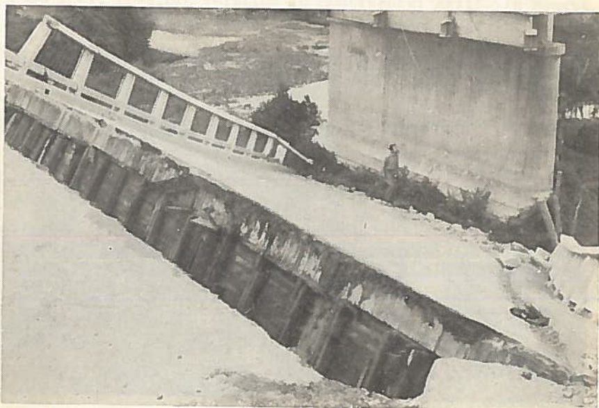
Foto 4. Bloque caído en el Puente Pullalli. Vista mirando en dirección N 25° W.
